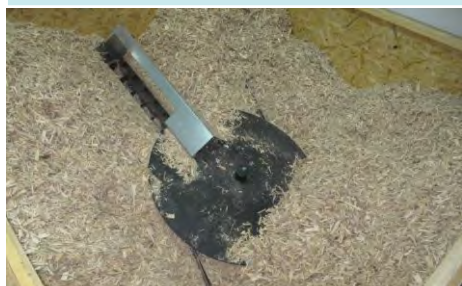
Prostorija/spremnik sječke sa mješačem spojenim na transporter
